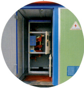
变电站高压室
