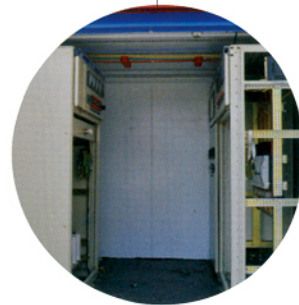
变电站低压室
